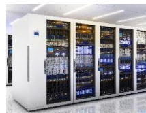
サーバー用ラック
