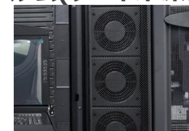
サーバー内ファン
