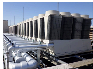
埼玉工場に導入した空冷式チラー
