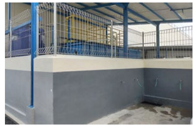
AKSプレジジョンボール・インドネシア社に導入した排水処理施設
