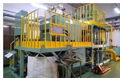
NSK昆山社で更新したろ過機
