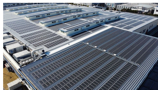
藤沢工場に設置された太陽光発電機
