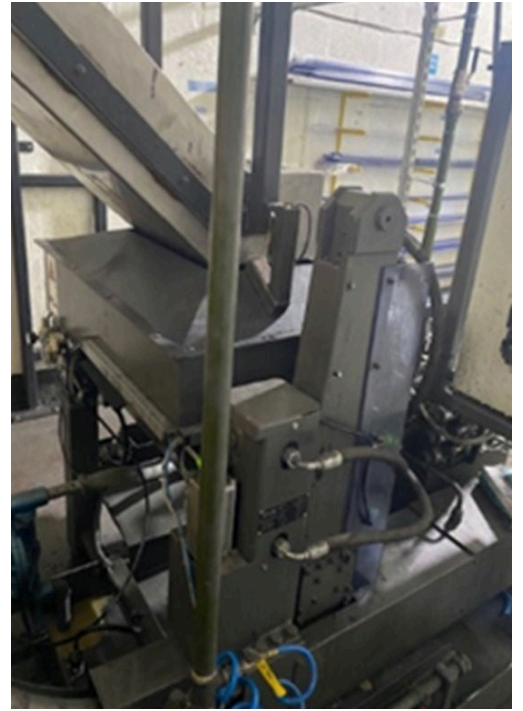
ピータリー工場に導入したブリケット化設備
