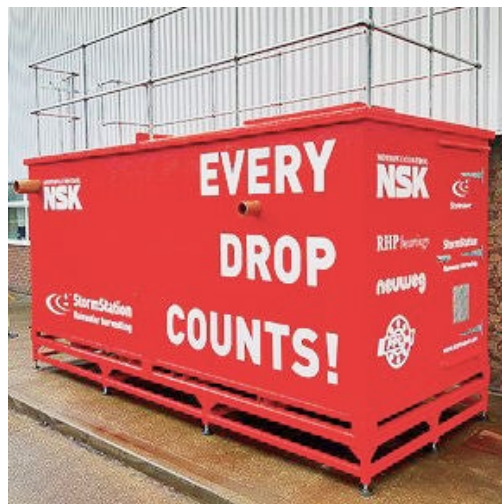
ニューアーク工場に導入した雨水回収設備
