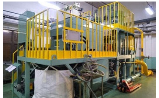
NSK昆山社で更新したろ過機
