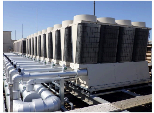
埼玉工場に導入した空冷式チラー
