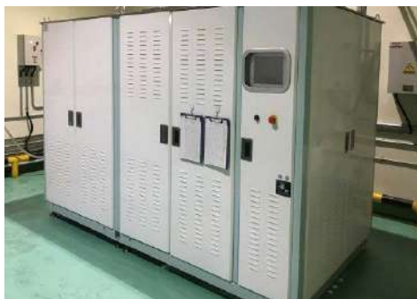
AKSプレジジョンボール杭州社に導入した廃液処理設備
